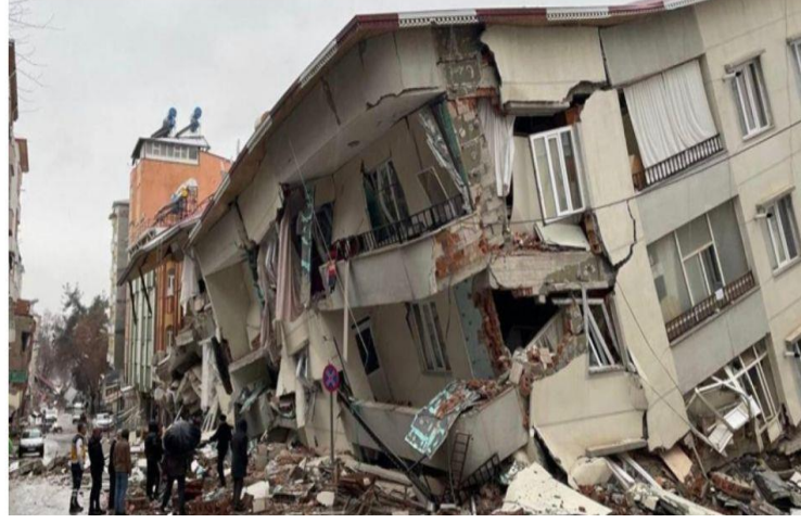
Şekil3. Yumuşak kat düzensizliği etkisinden yıkılmış yapı, Kahramanmaraş
