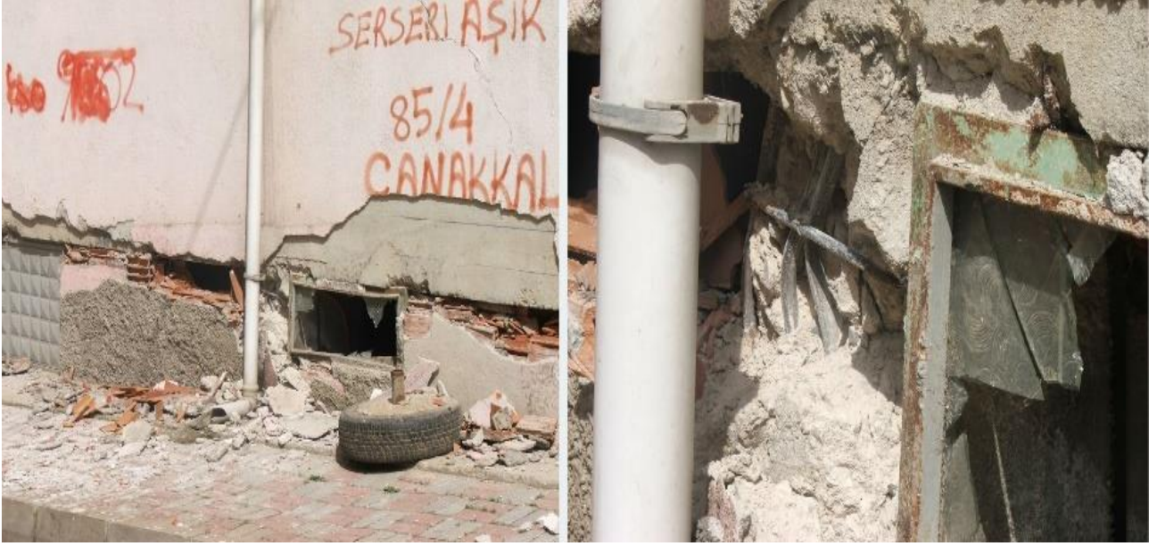
Şekil 2. Kısa kolon etkisi yüzünden ağır hasar almış yapı.
