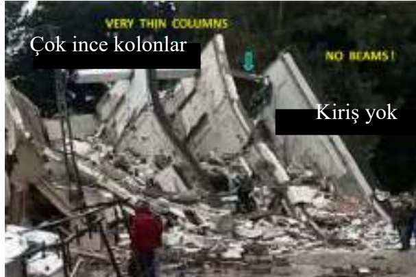
Şekil 12. Depremde yıkılan bir bina (Kahramanmaraş 2023)
