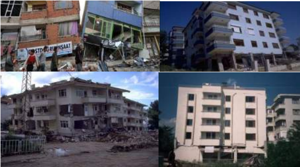
Şekil 1. Yumuşak kat etkisi görülen yapı hasarları
