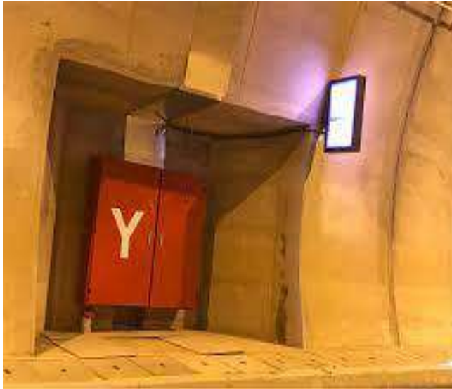
Şekil 2. Tünellerdeki Yangın Dolapları
