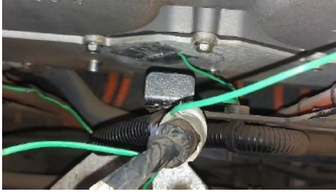
Şekil 3. Motor Kontrol Ünitesi Yüzey
